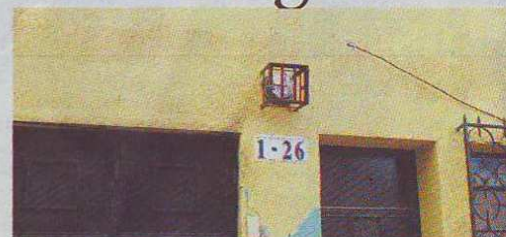
Los contadores de luz son protegidos con rejillas.
